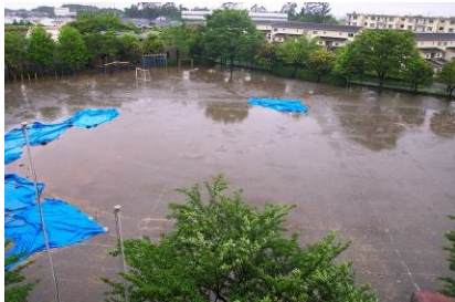
雨が降ると吸い込めなくなった水が湖面のように溜まりました(H20.5.20)
