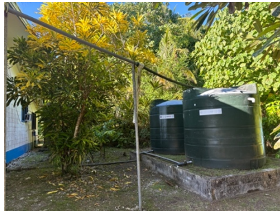
↑学校にある貯水タンク
