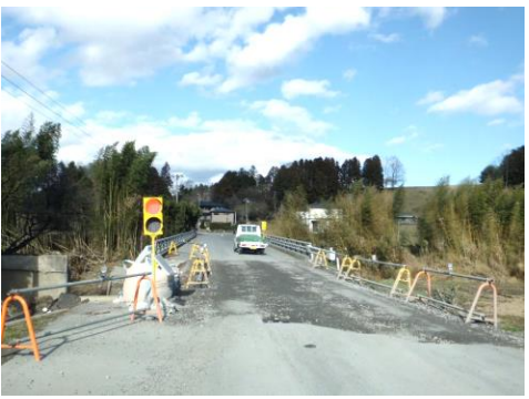
(鳥内橋) 未だ台風の爪痕が残る社川流域の「鳥内橋」と「梁瀬橋」
