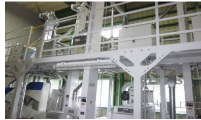
③精米機の全景
